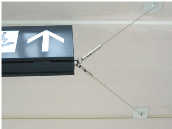
駅構内振れ止め
