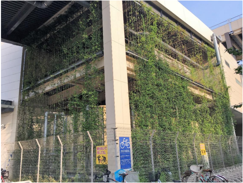
イオン東久留米① ストライプ仕様×支柱：Lアングル
