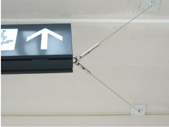
駅構内振れ止め
